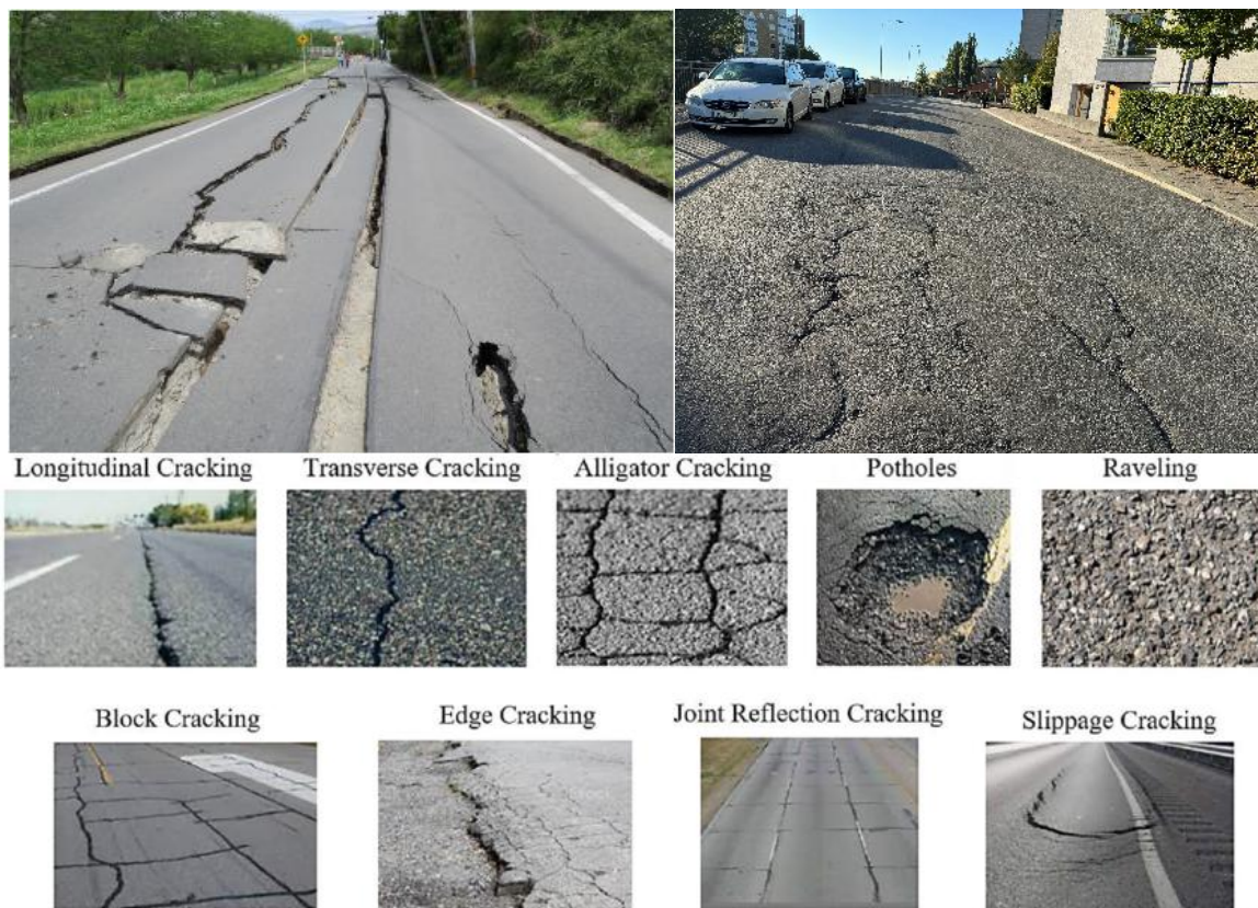
Figure 1. Các dạng hư hỏng do lún lệch trong công trình đường bộ (nguồn Internet)
