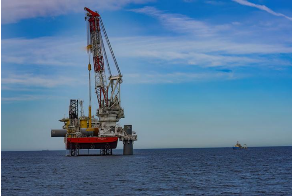
Hình 4. Cọc monopile được thi công tại trang trại điện gió ngoài khơi lớn nhất từ trước đến nay của Scottish Power.
