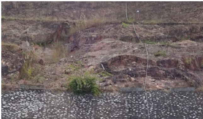
Hình 2a. Hiện trạng sạt lở chân cầu Bãi Cháy, Quảng Ninh
