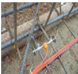
a) Cảm biến biến dạng trong bê tông
