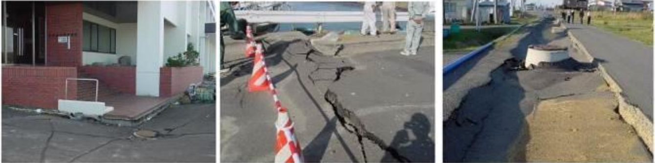
Hình 7. Một số hình ảnh thực tế về hậu quả của hiện tượng hóa lỏng
