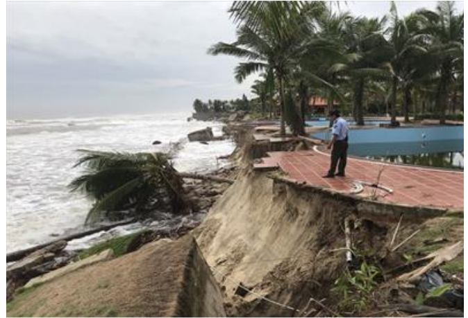
Hình 3. Sạt lở bờ biển tại tỉnh Quảng Nam.
