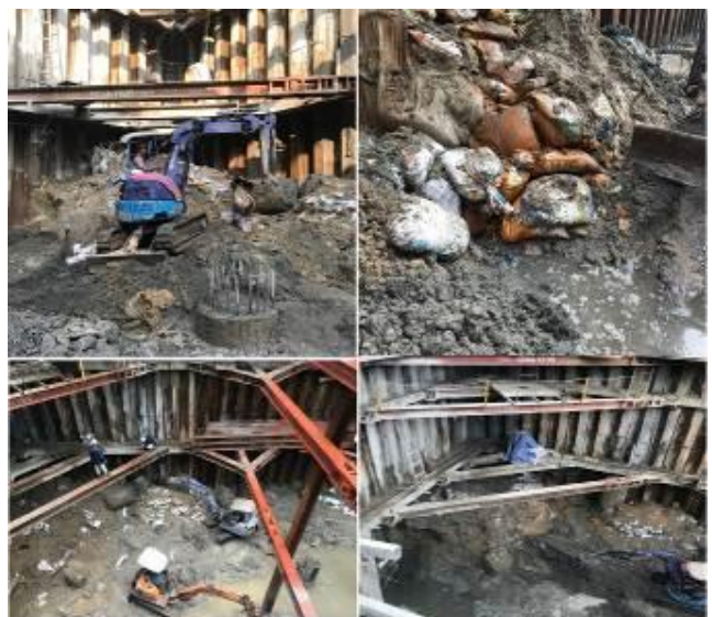
Hình 1. Sự cố thấm nước hố đào sâu - Dự án Chicland Hotel Đà Nẵng
