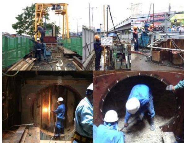
Hình 4- Xử lý CG hố đào sâu phục vụ khoan kích Pipe jacking – Dự án môi trường nước TP.Hồ Chí Minh II – gói G
