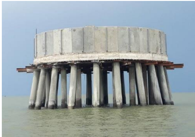
Tấm tường bê tông lắp ghép
