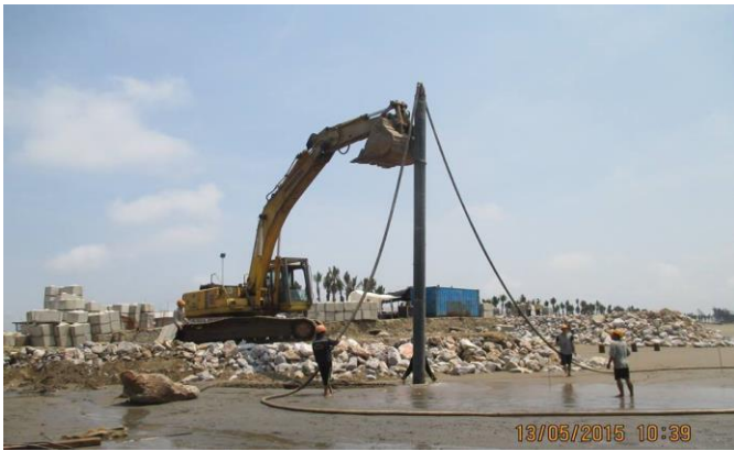
Hình 2. Hạ cọc ống bằng máy đào kết hợp với bơm nước biển lưu lượng lớn vào bên trong cọc
