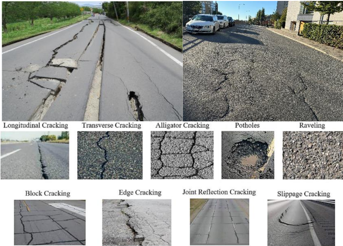
Figure 1. Các dạng hư hỏng do lún lệch trong công trình đường bộ
