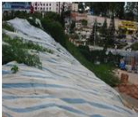
Hình 1. Hiện trạng công trình sau hiện tượng dịch chuyển của tường chắn
