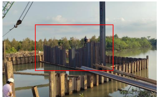
Hình 16. Cừ được cầu lắp vào vị trí thi công (khung màu đỏ)
