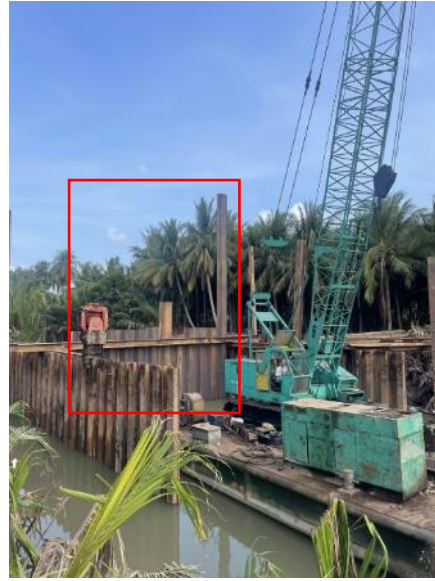
Hình 14. Mặt bằng thi công cừ chống thấm trên sông (khung màu đỏ)
