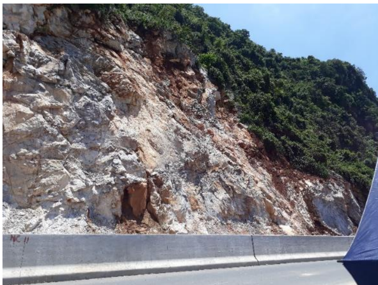
Hình 9. Khối trượt tại km 19 +40
