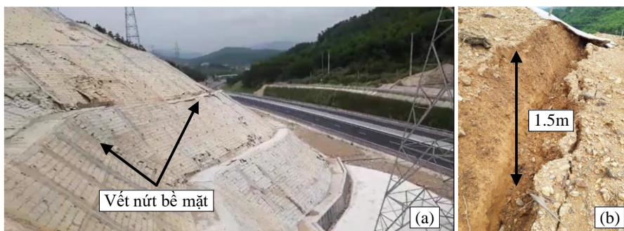
Hình 5. Khối trượt tại km 34
