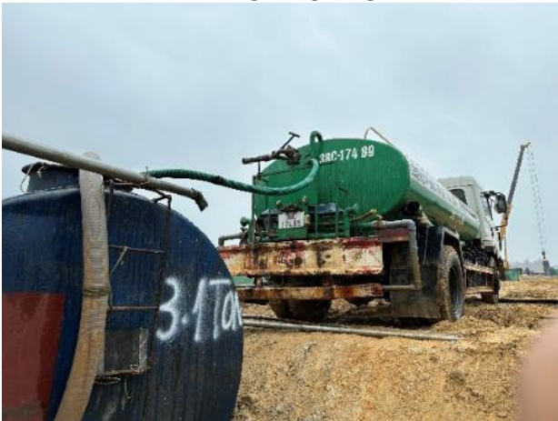
Hình 10. Cấp nước cho máy bơm áp lực
